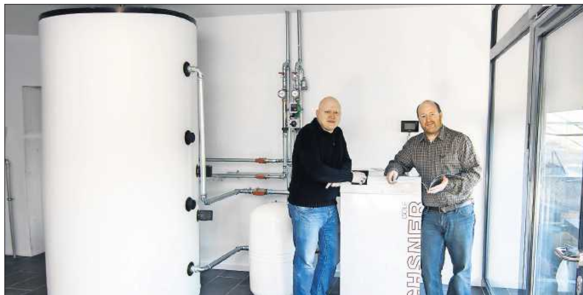
Das vor wenigen Wochen bezogene neue Firmengebäude am Kreuzberg dient Michael Burkhard (links) und Peter Burkhard auch dazu, optimierte Haustechnik zu demonstrieren. Unter anderem eine Wärmepumpe mit einem 1500-Liter-Pufferspeicher gehört dazu. FOTO: STEINMETZ
